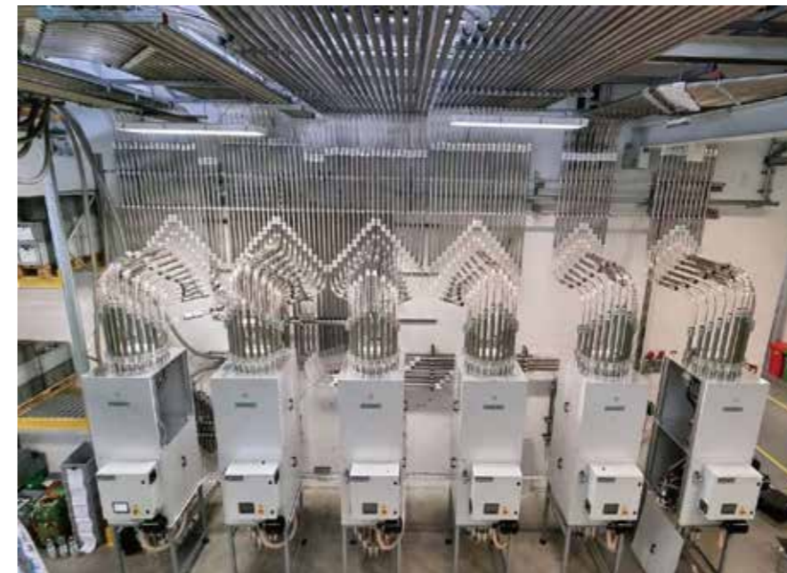
自动配料站现场图 Automatic Coupling Station
