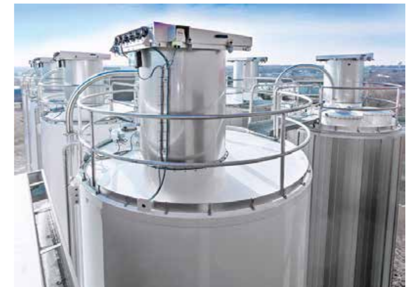
储料仓顶部脉冲除尘器 Top Pulse Dust Collector
